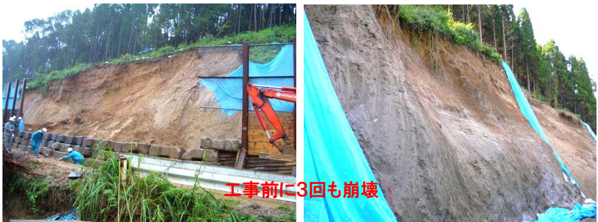
工事前に崩壊したシラス斜面（円弧型の崩壊は極めて風化したシラスで稀に発生）
