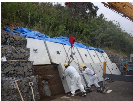
受圧板設置中 鉄筋コンクリート製の 1500×1500×300 の受圧板をクレーンで吊るして設置していま す。
