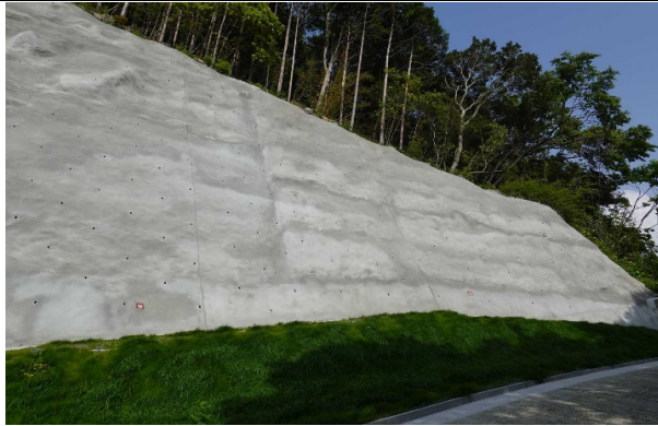
日置市 伊作田現場(モルタルの上に突出物が見えません)
