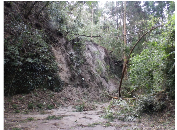
図-4 今城と本丸間の空堀斜面の崩壊
