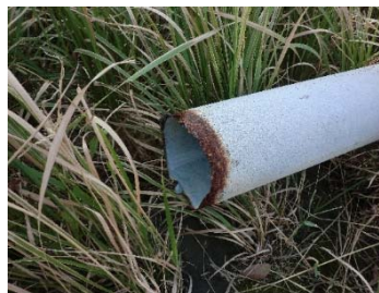
土壌部分で錆びて折れたメッキパイプ
