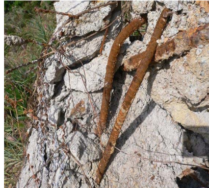
吹付法枠内で腐食した鉄筋 (建設後17年経過)
