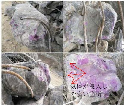
灰色部は中性化部 ピン部は健全 6年経過後
