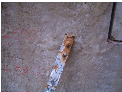
20年で腐食し破断した土壌中のストリップ (100年の耐久性があるとされていた。)
