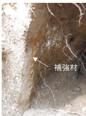
錆びだしたメッキ補強材 建設後20年
