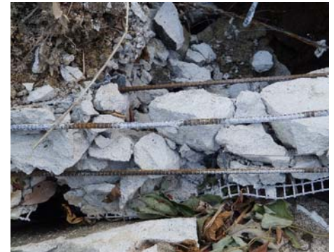
吹付法枠内で腐食した鉄筋 (建設後5年経過)
