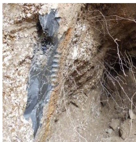
建設後 20 年経過したメッキ補強材 （メッキは溶解し残ってはいない）
