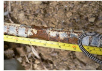
図-4 建設後 17 年で発生していた断面欠損
