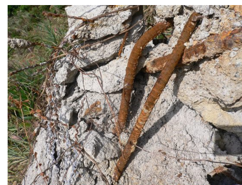
図-13 建設後17年で折れた吹付法枠箇所
