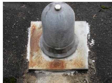
図-8 約 25 年経過したメッキ材 海岸から 50m 地点
