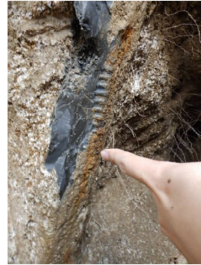
図-5 補強材のメッキ溶解 20 年経過後
