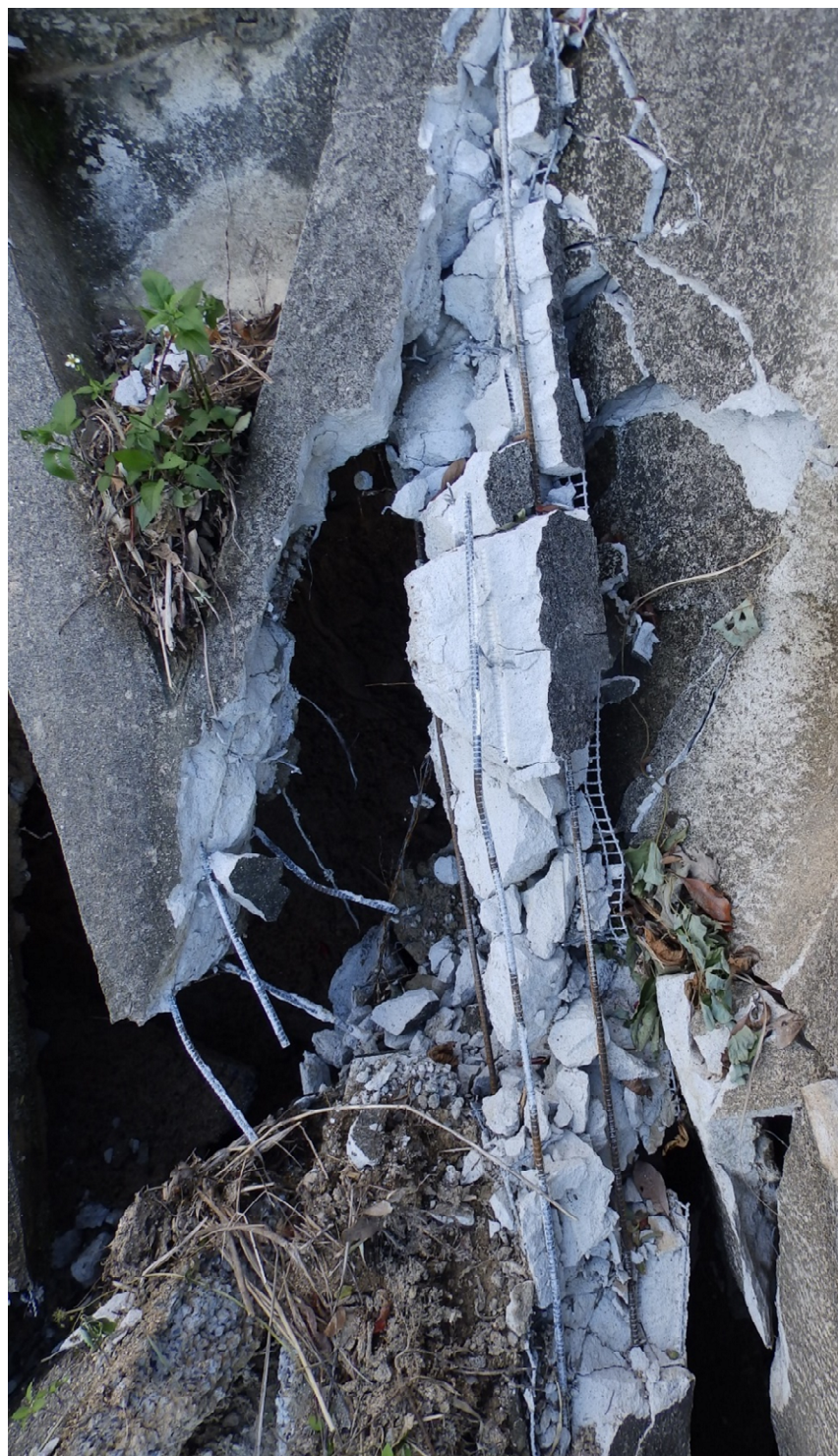
図-11 建設後4年で鉄筋が錆びていた吹付法枠
