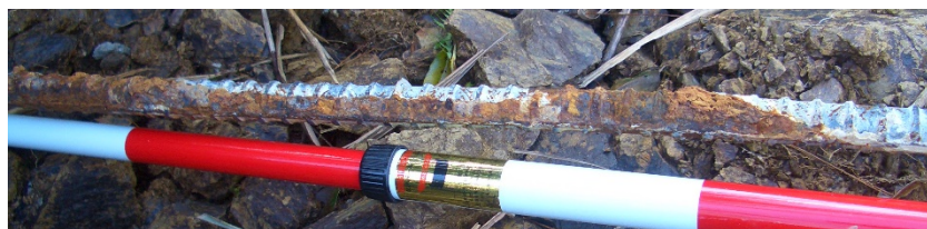
図-2 建設後 17 年で腐食した補強材（無メッキ）
