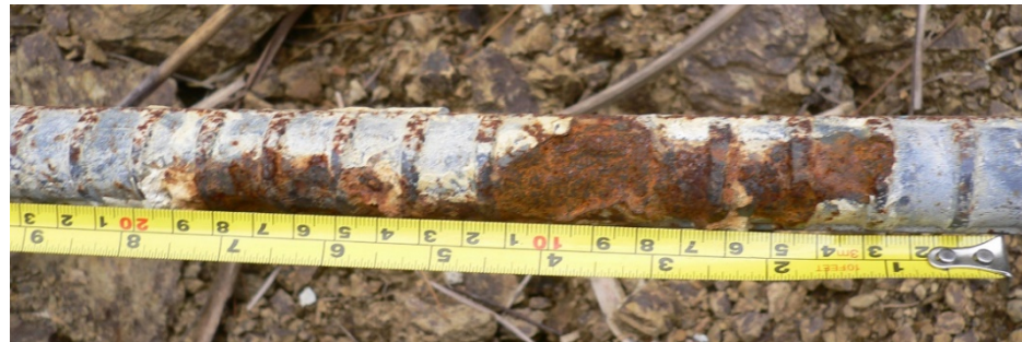
図-6 孔壁崩壊が起きたと考えられる箇所
