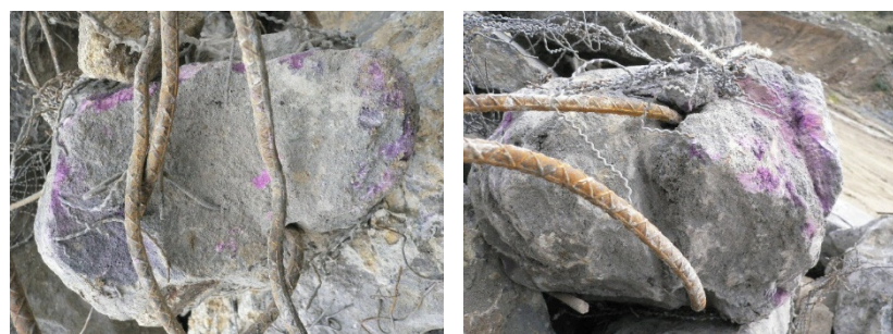
図-12 建設後6年で鉄筋が錆びていた吹付法枠 (ピンク色部分のみがアルカリ性を維持)
