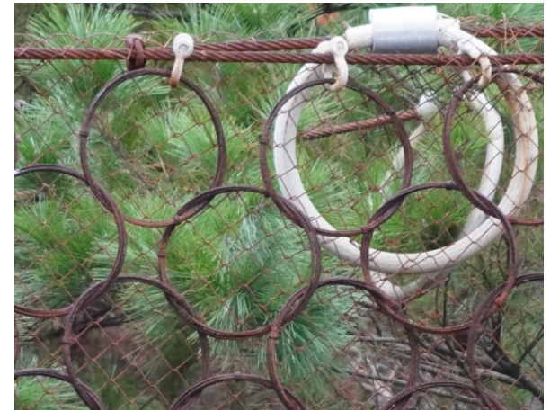
図-9 海岸近くの落石防護工は直ぐにれます。
