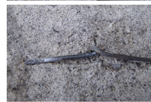
図-16 2年で錆び始めた吹付モルタル内部のラス金網 既にメッキは消失している
