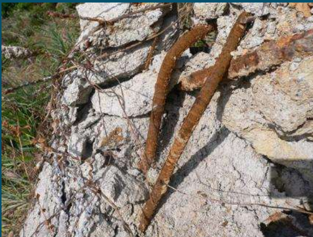
17年で鉄筋が錆びて法枠破断
