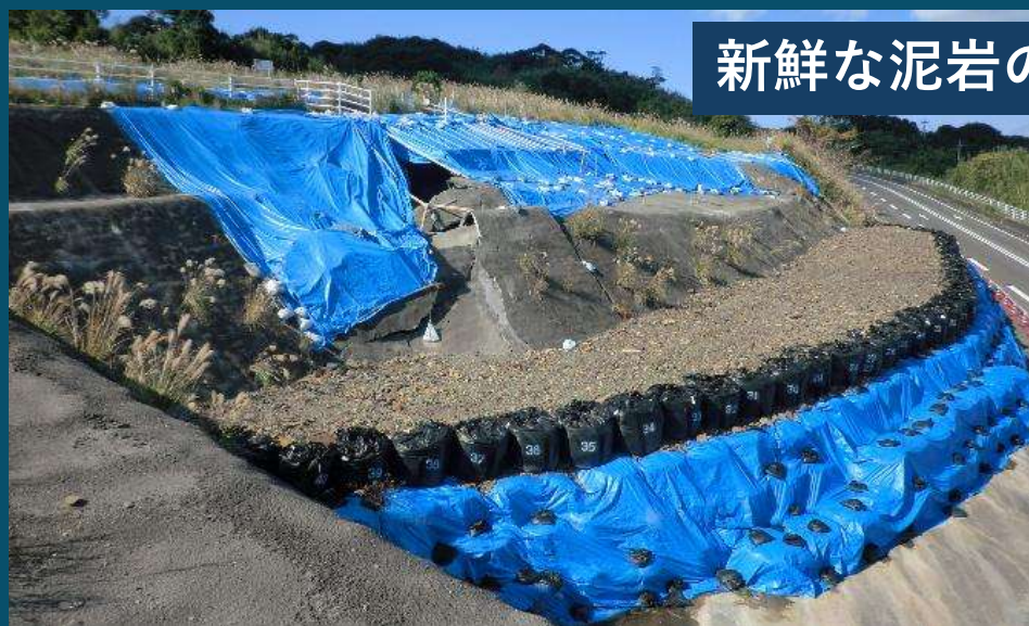
切土後再崩壊
