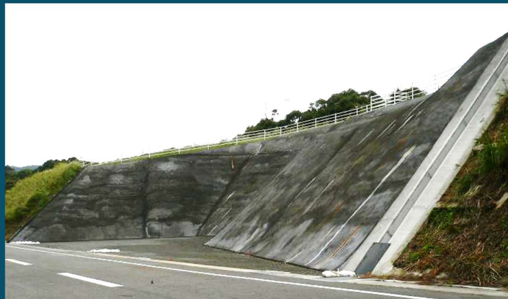
1回目の崩壊後の切土
