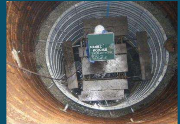
補修後小さな内径で 集水ボーリング工事不可
