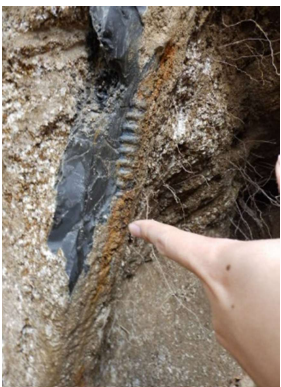
図-2 補強材のメッキ溶解（20 年経過後）
