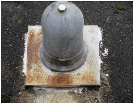
図-7 約 25 年経過したメッキ材 海岸から 50m 地点
