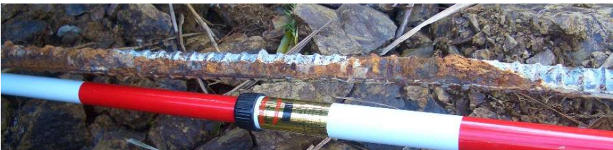
図-3 孔曲がりにより腐食した補強材（無メッキ）
