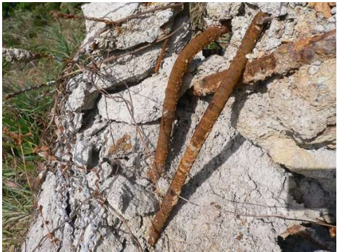
図-9 建設後 17 年で折れた 吹付法枠箇所
