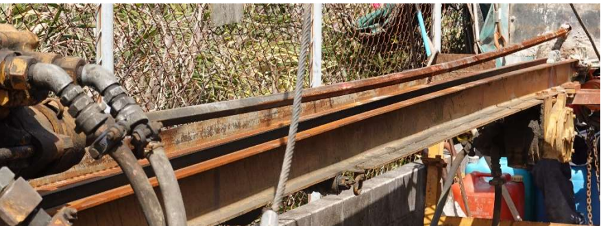
図-5 曲がっている掘削ツール
