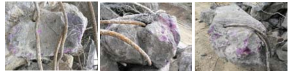
図-7 30cm 断面の吹付法枠の中性化状況 紫色部分以外は中性化 (建設後 6 年経過)
