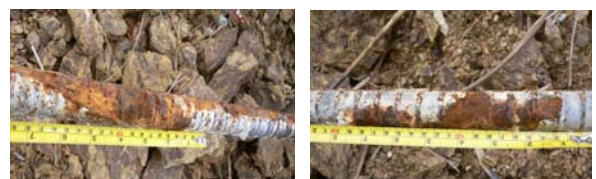
図-10 補強材の断面欠損部分 (建設後 17 年経過) (めっきしていない補強材)
