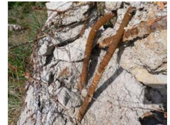
図-9 吹付法枠内で全面表面が腐食した鉄筋 (建設後 17 年経過)
