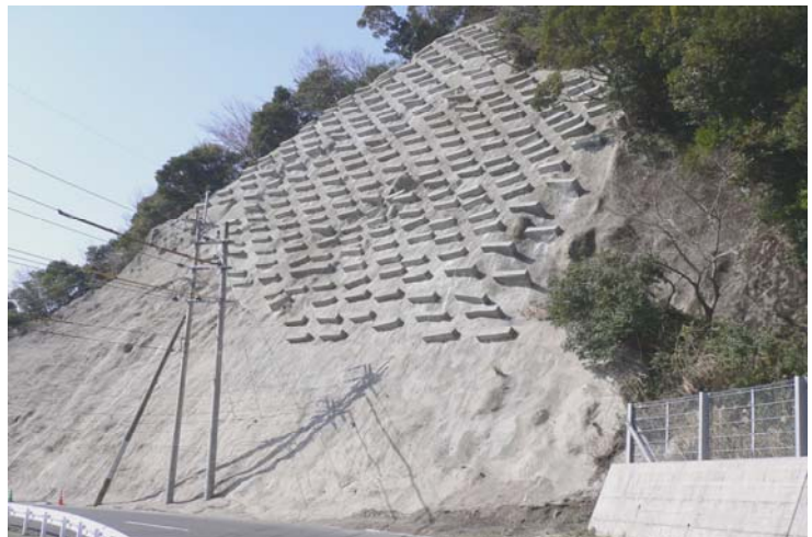
図-11 老朽化モルタルの補修事例
